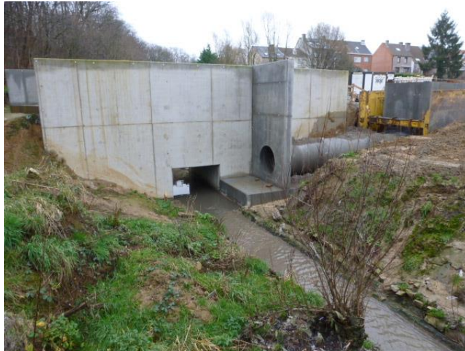
Foto: stuwconstructie op Tangebeek met uitlaat bufferbekken Aquafin (© Bart Van Beneden)
