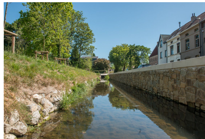
Opgelegde IJse ter hoogte van de J.B. DE Keyserstraat in Overijse (© provincie Vlaams-Brabant)
