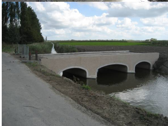
Werken aan de brug over de Grote Beverdijkvaart (foto's VMM AOW – Dirk Dejaeger).
