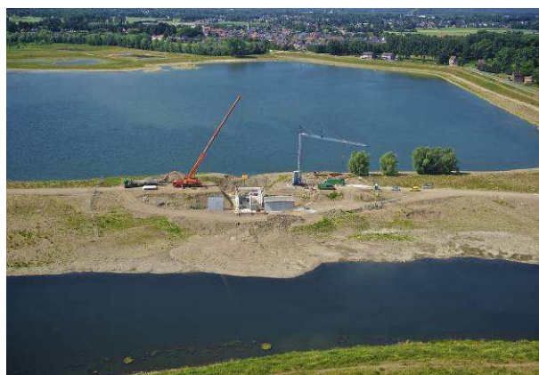
Foto 1. Werken aan het rivierbed van de gemeenschappelijke Maas ter hoogte van Herbricht (boven) en plaatsen van de verbandsconstructie tussen de Maas en de westelijke plas van Negenoord (onder) (foto's: H. Gielen – nv De Scheepvaart)
