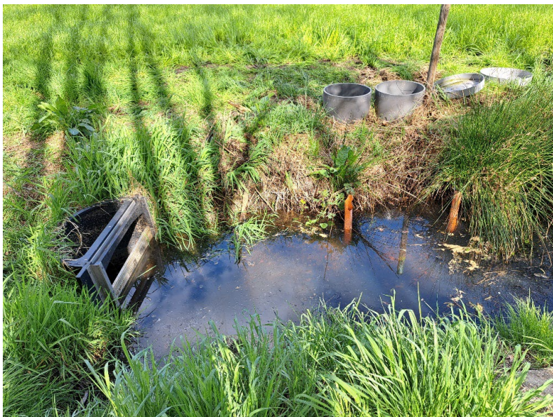
Voorbeeld van een landbouwstuw in een gracht in combinatie met inlaat voor subirrigatie.
