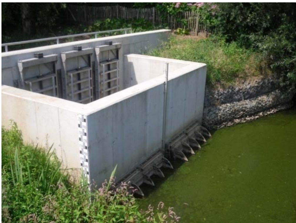
Figuur 2 : Doorvoerconstructie in de Oosterdijk met de twee geplaatste terugslagkleppen (rechts op de foto).
