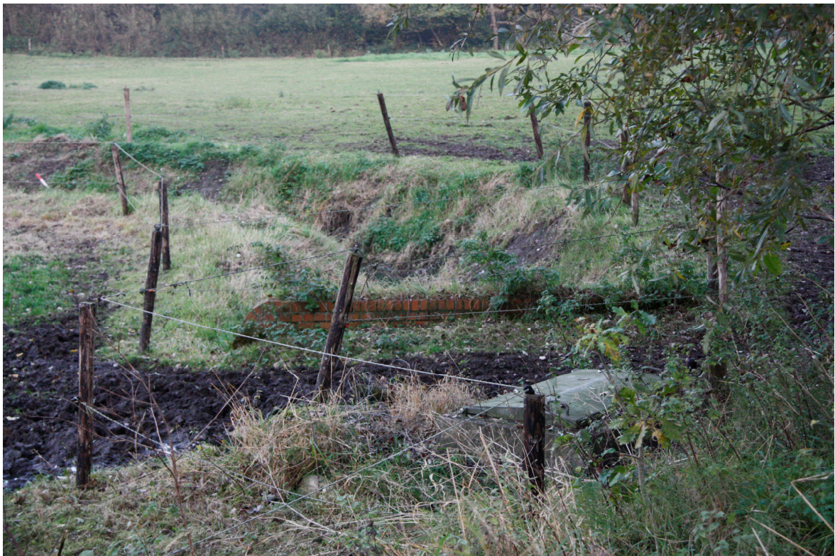
Figuur 9: Overstort t.h.v. het punt waar de ingebuisde waterloop WH.10.11.1 in open bedding komt.
