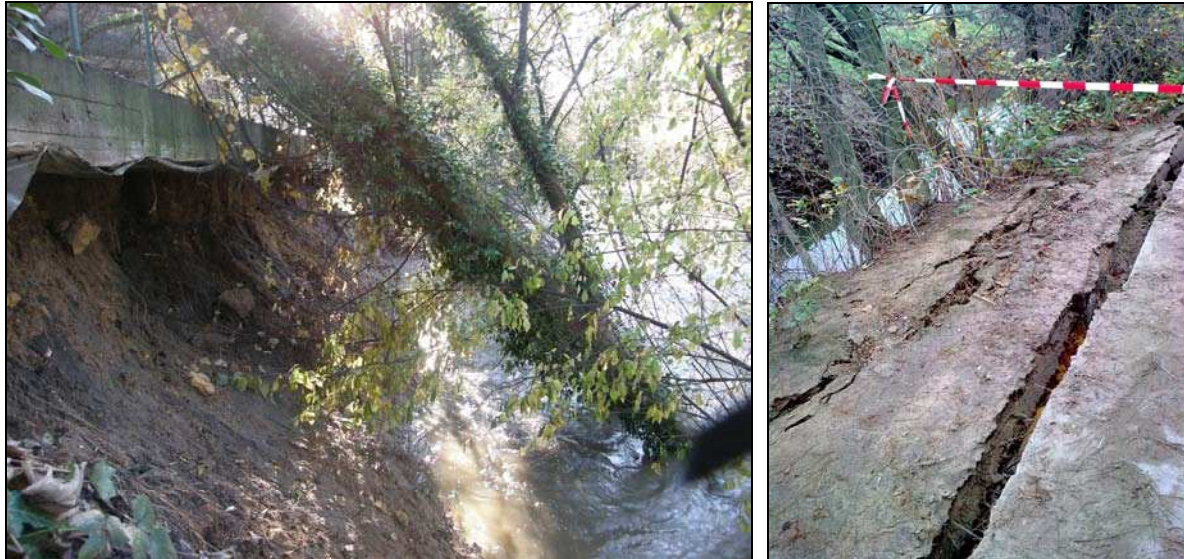
Figuur 136 Uitschuring en beschadiging oprit t.h.v. de Louis Thevenetlaan in Halle
