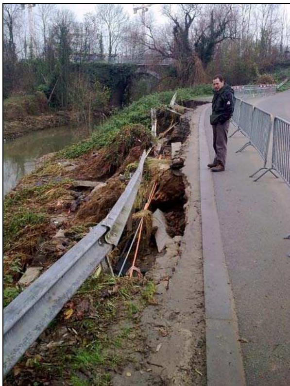
Figuur 133 Afschuiving van de Zenne-oever ter hoogte van de Suikerkaai in Halle
