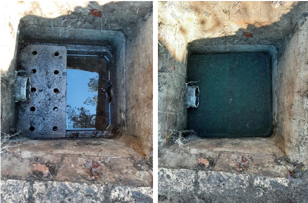
Figuur 7: voorbeeld van een voorfilter in een toezichtput voor de hemelwaterput
