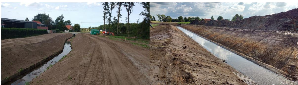
Figuur 11: uitvoering van de waterbeveiligingswerken aan de Gaverbeek rond de wijk "Torhout-Oost" (©Provincie West-Vlaanderen – Dienst Waterlopen)
