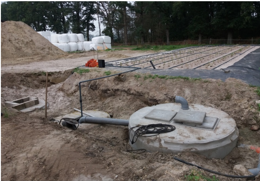
Figuur 15: Foto's boven: een zijgracht van de Oude Lossing was ernstig vervuild door structurele problemen op een bedrijf. Ook de teeltvrije 1m zone werd er niet gerespecteerd met duidelijke afkalving tot gevolg. Foto onder: een deel van de structurele oplossingen die het bedrijf kort nadien heeft genomen.
